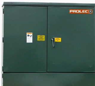
TRANSFORMADOR TIPO PEDESTAL
